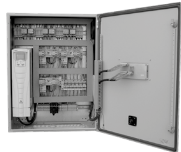
CUADRO CON VARIADOR DE FRECUENCIA
